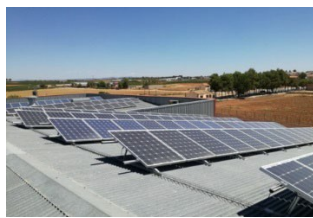
Instalación tipo vela
